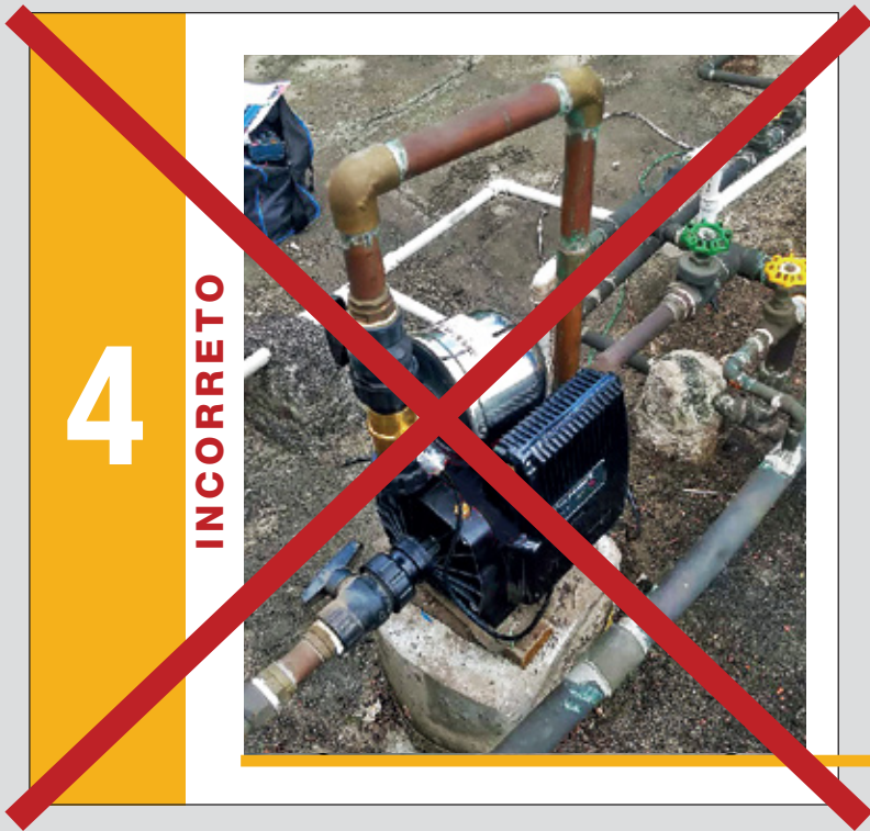
4) Mejoras: a) Equipo instalado a tiempo b) Instalación sin la válvula original suministrada con el equipo.
