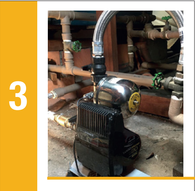
3) Buenas prácticas: a) Uso de bomba de reserva b) Uso de flexibles
